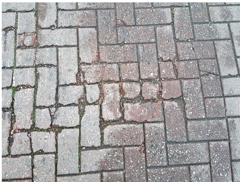
Foto: Detailansicht mit Schleifspuren auf den Steinen
