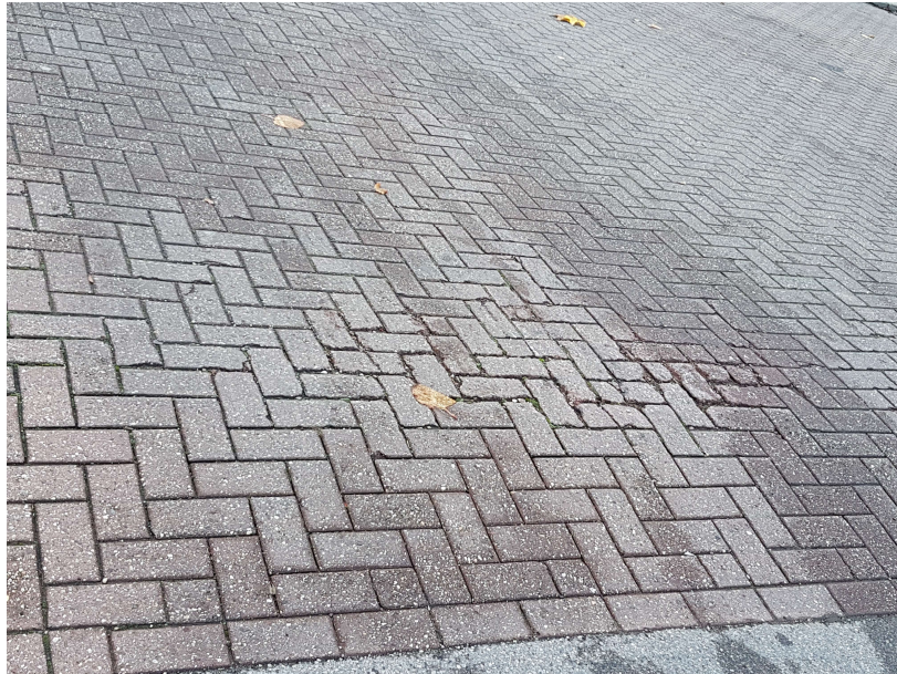
Foto: Zustand der Steine vor dem Eingang der Schule
